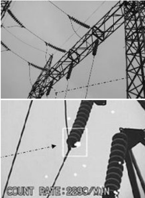
그림 5. 154kV 옥외수전실의 현수애자 코로나 현상 검출
