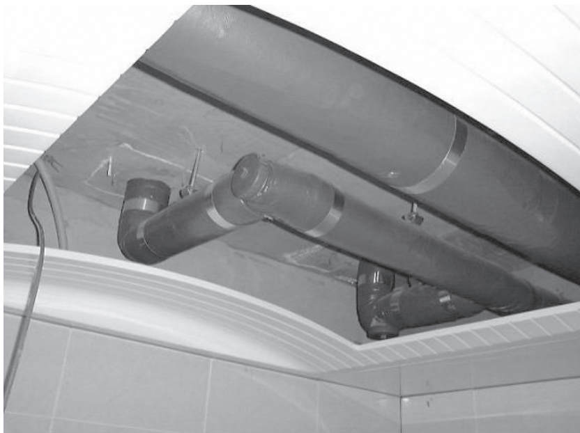
▲ 세대내 오배수관(양변기 삼중엘보+이중부속+배관보온+섹스티아)
