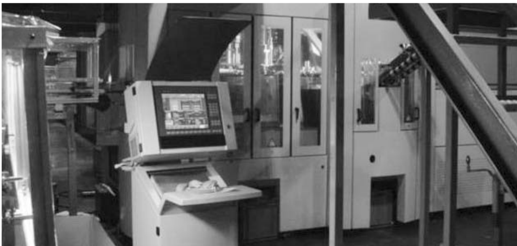
▲ (주)삼양사 용기BU의 Blower
