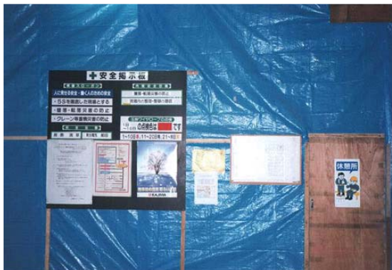
[사진 1] 출입구 안전시설물 및 안전표지판
