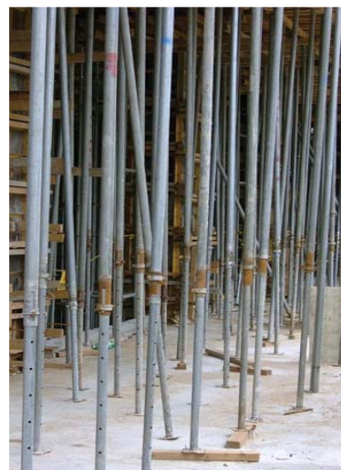
[사진 5]. 수평연결재 설치 불량
