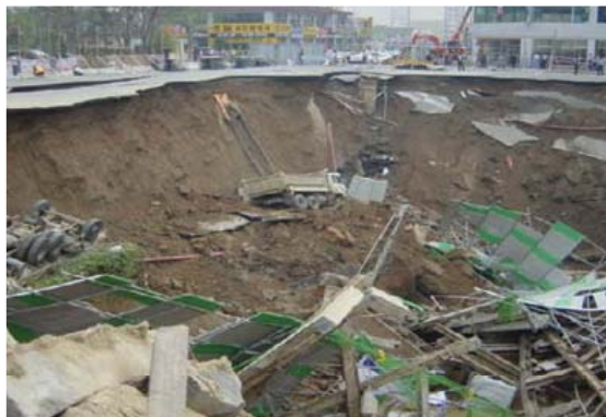
[사진 1]. 흠막이 붕괴사고 사례
