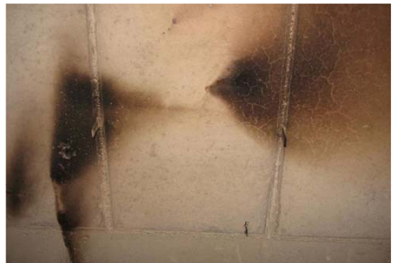
[사진 7]. 공사장내 화기사용에 따른 품질결함
