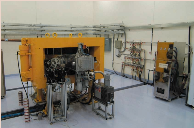
▲ 부산대학교 사이클로트론연구센터에 설치된 13MeV 사이클로트론과 부대장비
