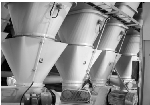
▲공장내 설치된 사료빈 광경(총 36개의 사료빈이 설치되어 있다.)
