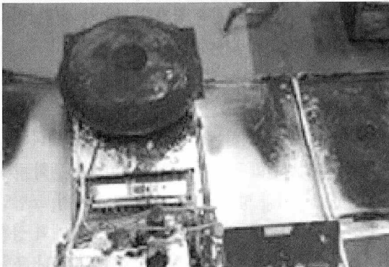
보일러 분해 상태
