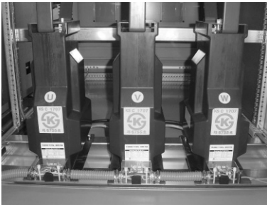
▲ 24KV MOLD형 MOF
