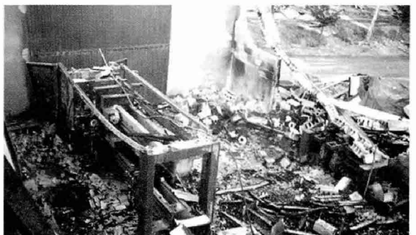
● 사진 4 ● 2층 작업장 소손 흔적
