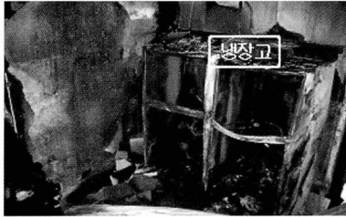
■ 사진 1. 벽면 및 냉장고 소실 모습
