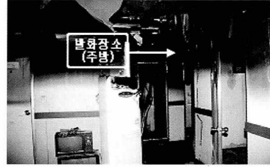
■ 사진 3. 천장 부분의 소실 및 에어컨 용융모습
