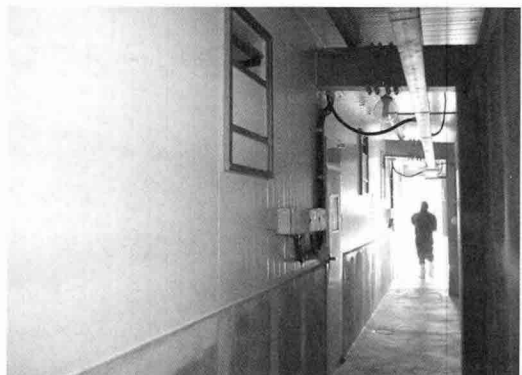
▲ 완벽한 단열시공과 함께 첨단 보온등 컨트롤러를 사용해 섬세한 난방, 온도조절이 가능하다.
