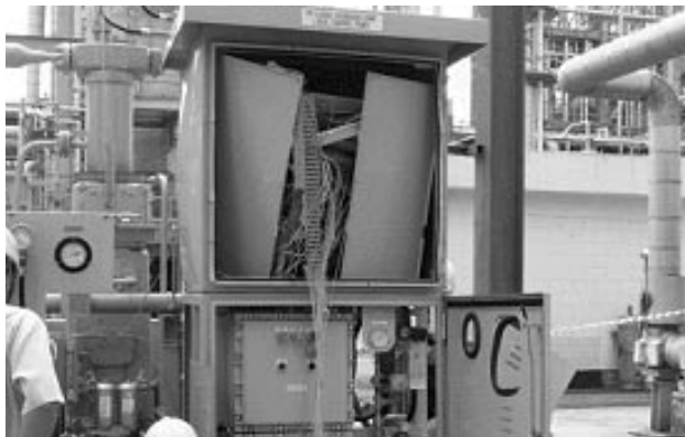
<그림 6> 울산 합성수지 공장의 파손된 조작 패널
