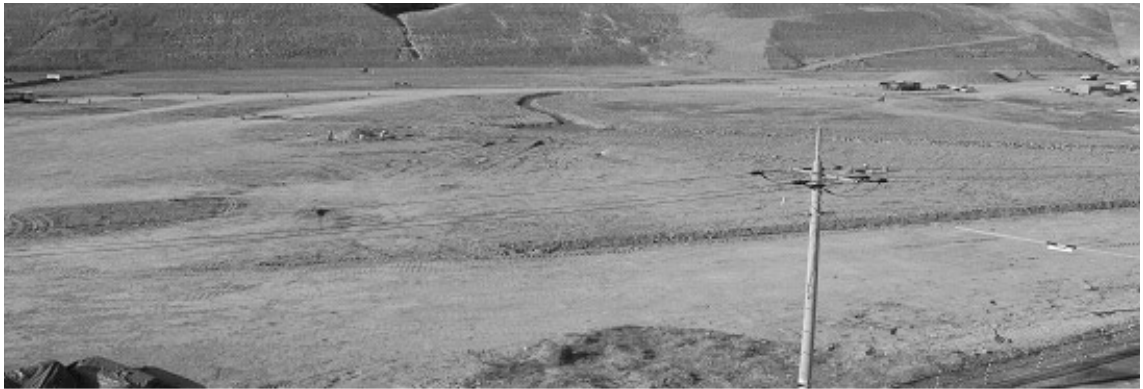
신월성 원전 1,2호기 건설 현장. 삼성물산(주) 건설부문은 시공중인 신월성 원전 1,2호기 공사의 성공적인 준공을 위해 완벽한 사업 관리에 최선을 다할 것이며, 보다 안전한 원자력발전소를 건설하고, 나아가 한국표준형원전의 해외 수출을 위해 범국가적인 노력을 경주할 것이다.
