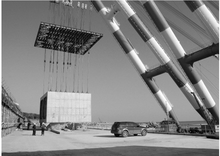
심층 취·배수 공사. 국내 원전 최초로 건설되는 침매 터널 공사로서 태풍 등 온갖 악조건 속에서도 성공적으로 공사를 수행함으로써 기술면에서도 국내 선도적 회사임이 입증되었다.
