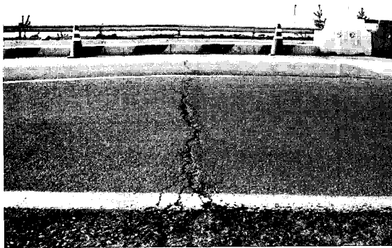
그림 6. 정읍영업소 광장부 포장 파손
