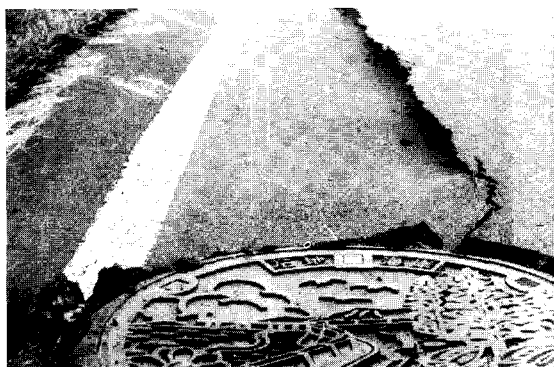
사진 1. 맨홀 및 도로의 파손
