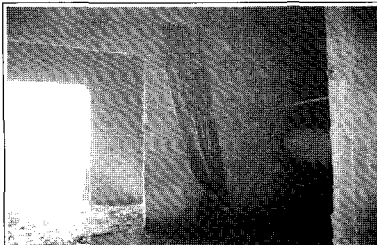
스펀지+부직포+천막을 이용한 터널내 고정식 방음시설
