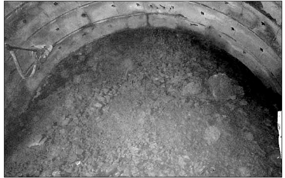
그림 16. 장연터널 막장 붕락 전경
