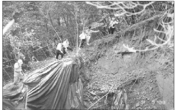
그림 17. 장연터널 상부 지표 함몰 전경
