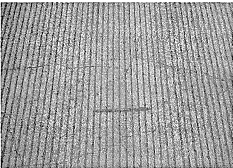
그림 5 망상형 균열 발생사례(미국)
