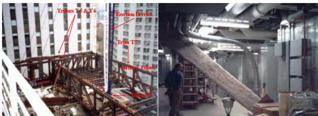
그림9. 기계실 내부와 공사사진
