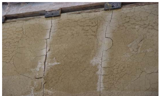
④ 스틸를 따라 발생한 수직균열
