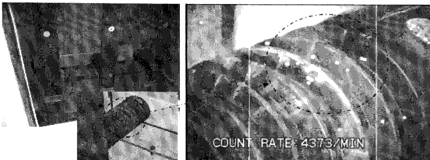
그림 6. 22.9[kV] 유입식 변압기 2차측 22.9[kV] BUS 지지애자의 코로나 현상
