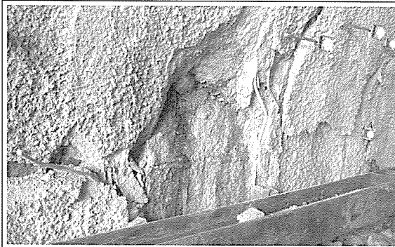
Shotcrete 변상 현황
