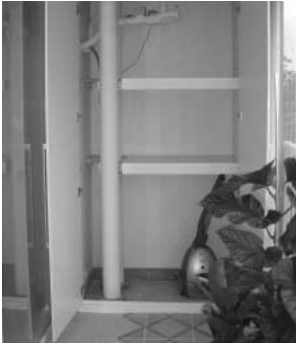
▲ 단위세대 냉방배관 (발코니 수납장 속에 냉방배관을 하여 공간 활용 및 미관을 향상시켰다)
