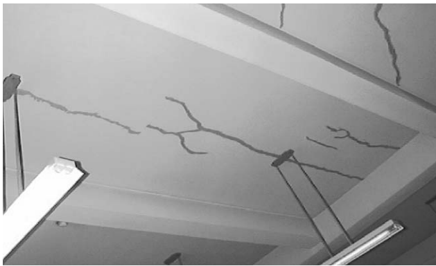
〈그림 1〉 완공 후 슬래브 균열 보수 사례
