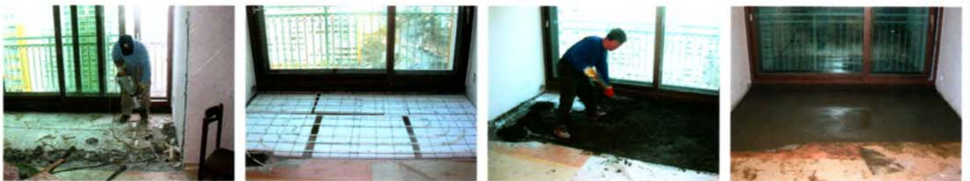
1 엑셀 파이프를 묻기위하여 콘크리트 바닥을 뜯어내는 모습 2 엑셀 파이프를 연결한 모습 3 미장하는 모습 4 마무리 모습
