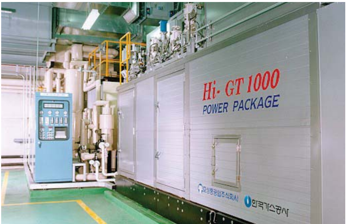
▶▶ 한국가스공사에 설치한 1000kW 가스터빈 열병합발전
