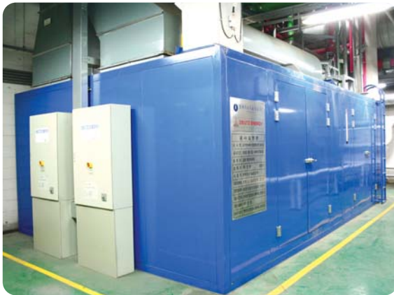
▲ 기계실 한편에는 481kW급 열병합발전기 2기가 설치되었다.
