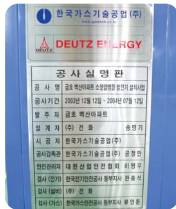
▲ 열병합발전기 외부에 설치된 명판의 모습
