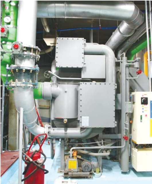
▲ 본관 기계실에는 기존 보일러를 없애고 250RT 냉동기가 설치되었다.
