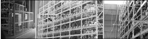
가드설치 접근한계거리설정 감응식 방호장치 및 경보기 설치
