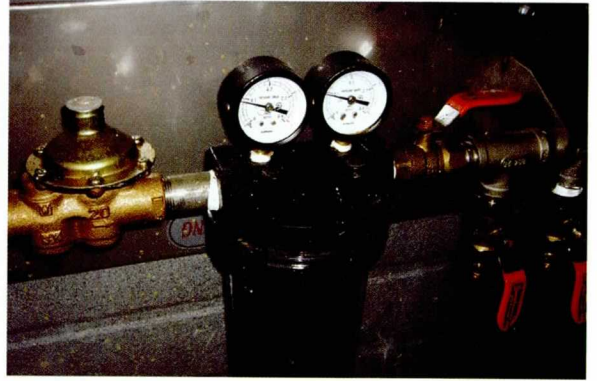
▶ 수압표시기. 수압이 떨어질 때 경보음이 작동하도록 장치 고안중
