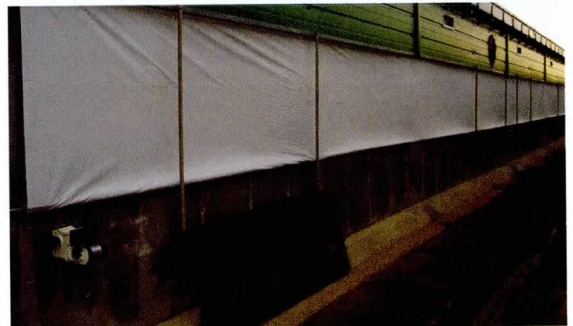
▶ 벽면에 설치한 윈치커텐으로 상하조절 가능
