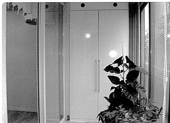
▶ 세대배관 완료 후의 모습, 실외기가 없어 외관이 깔끔하다.
