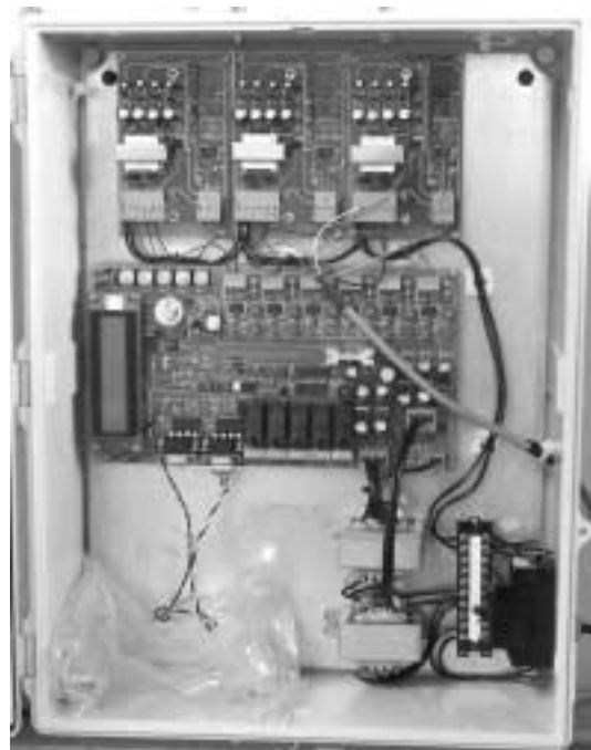
그림 8. 현장 제어장치 사진
