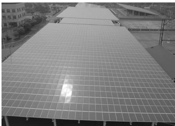
사진 10. 동해 태양광설비 전경
