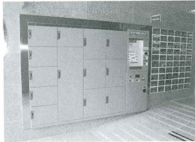
▲부천주상복합 리빙로제에는 빌트인 방식으로 설치가 이루어졌다.
