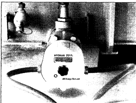
그림 6 변압기 유증가스 센서(HYDRAN)
