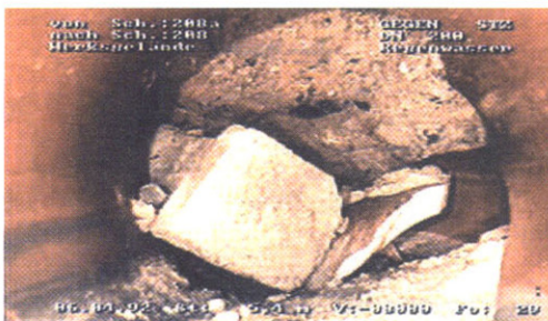
그림 3. 흙관의 파손, 붕괴
