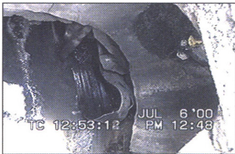
그림 2. 콘크리트 연결관의 함몰
