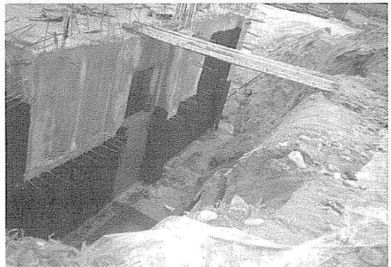
사진 1. 작업발판 설치 불량
