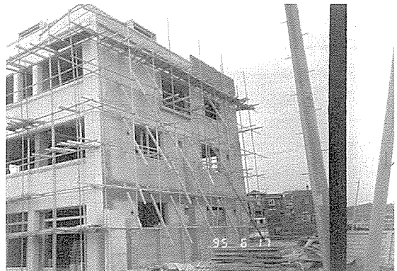
사진 2. 비계 및 작업발판 설치 미흡에 따른 추락위험
