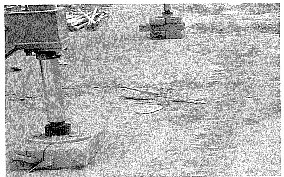
사진 9. 트럭크레인의 아웃트리거 설치 상태(아웃트리거(Outrigger) 설치 불량(2단이하))
