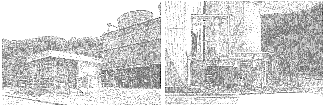
(A) 암모니아 하역, 주입 시설 (B) 희석공기 송풍기 및 혼합기
