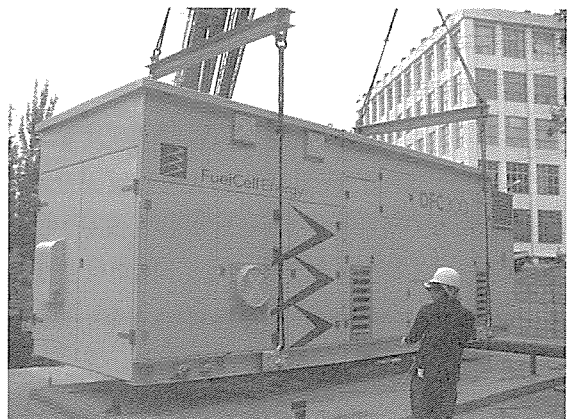
그림 3. 250kW MCFC 3호기 설치 모습 (광주 조선대학병원)
