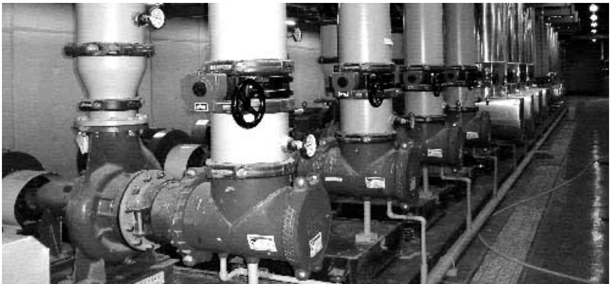
기계실 냉각수 펌프
