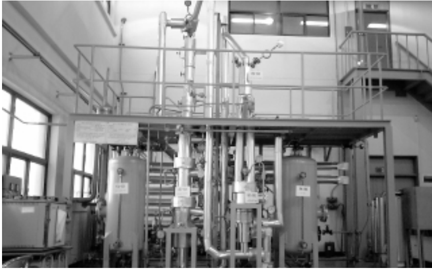
개질공정 Pilot Plant 전경 ▲
