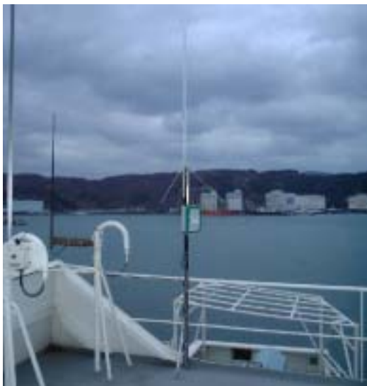
FIGURE 9. 선교에 설치된 중계기
