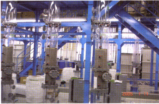
Fig. 1. 일본 국립보건연구과대학원 정수처리 Pilot Plant 내부.
