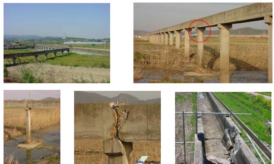
Fig. 13 교각 보 피복탈락, 기둥 기울음, 수로 충돌파손된 수로교
