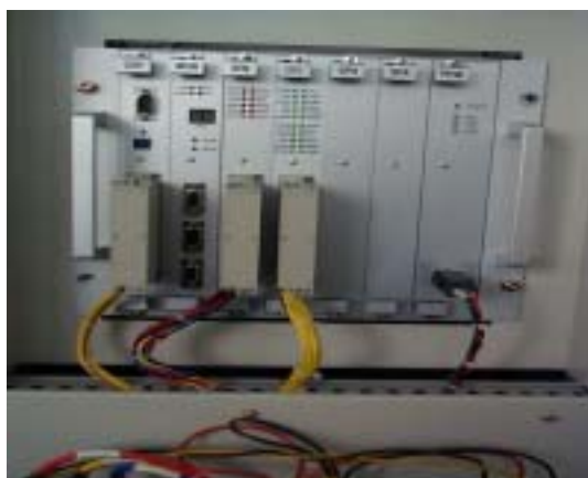
그림 4 모니터링 통신모듈부 Fig. 4 The photo of a monitoring communication module part
