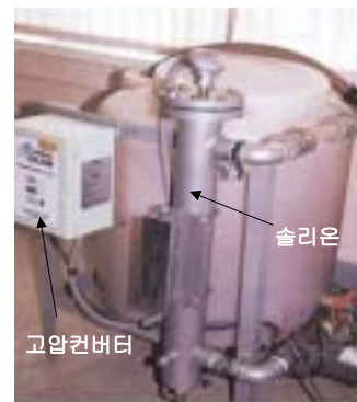
그림 17 전자장 수처리 시스템 설치 사례 Fig. 17 The establishment case of the electromagnetic field water treater system
