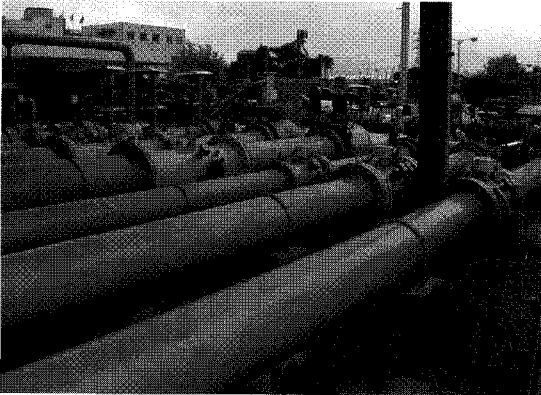
그림 3 유량계 전단에 설치된 직관부 모습
