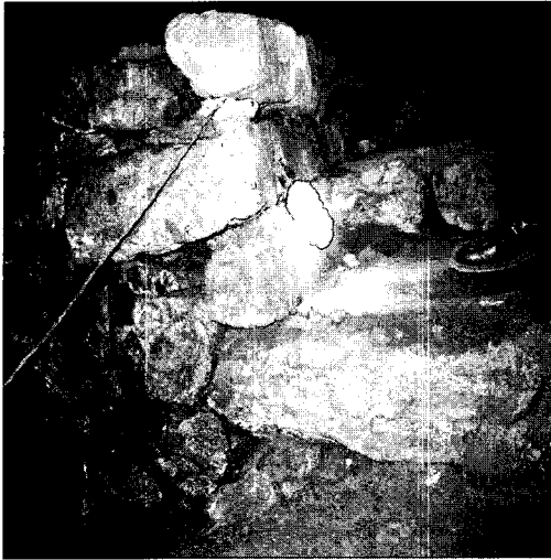
사진 1. 전선을 넣어놓은 상태이며 socket 에 전구만 끼워 놓아 관람객의보행에 지장을 주고 이로 인한 전선의 손상으로 감전사고 우려(천용동굴)
